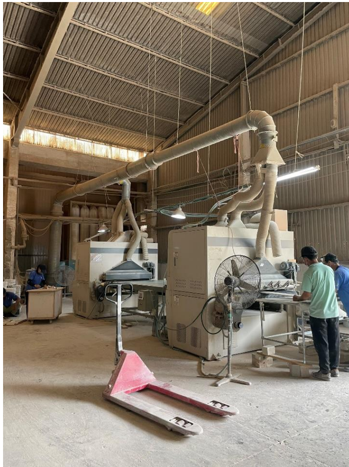
Hình 3-10 Hình ảnh HTXL bụi gỗ khu vực chà nhám mặt (chà nhám thùng)
